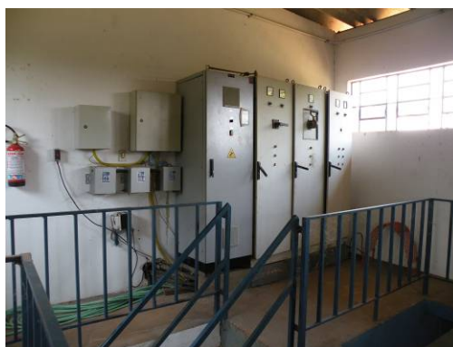
Figura 40 – Paineis das bombas.
