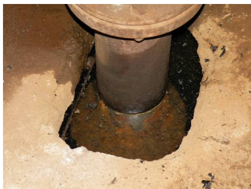
Figura 191 – Detalhe da tubulação de sucção da elevatória que está desativada (a elevatória está funcionando como estação pressurizadora).
