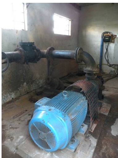
Figura 186 – Bomba de recalque e pressurização da água na tubulação que abastece os bairros da região norte da cidade.
