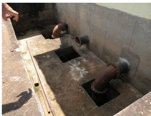
Figura 38 – Tubulações de sucção das bombas.
