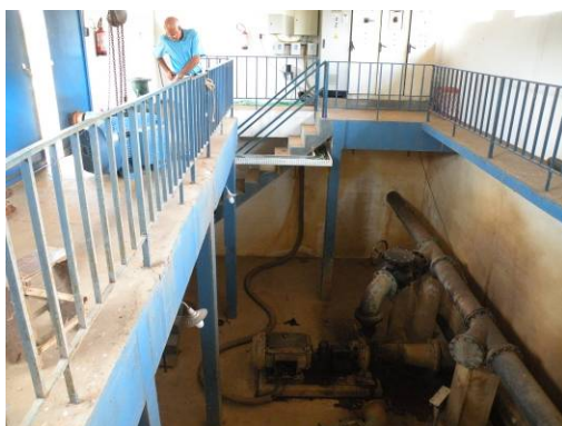
Figura 39 – Interior da casa de bombas nova.
