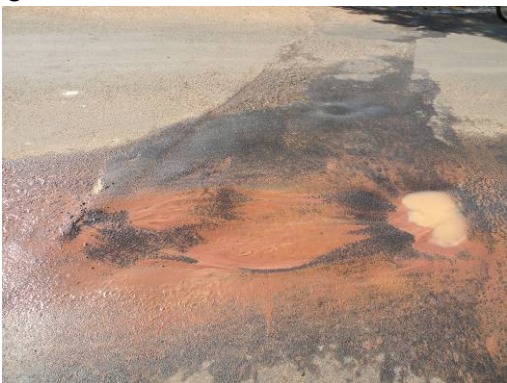
Figura 265 – Ponto de vazamento de água por rompimento de adutora na altura do nº. 402 da Rua Júlio Chefer no Jd. Salgueiro (vista 01).
