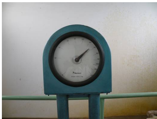
Figura 102 – Medidor de vazão da Calha Parshall.
