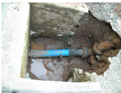
Figura 195 – Tubulação de recalque da elevatória (em manutenção).
