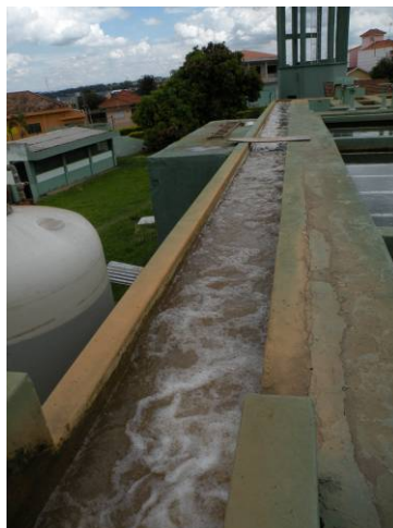
Figura 104 – Canal de distribuição de água para os Floculadores.
