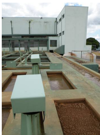
Figura 108 – Vista geral do processo de tratamento com prédio de administração ao fundo (vista 01).
