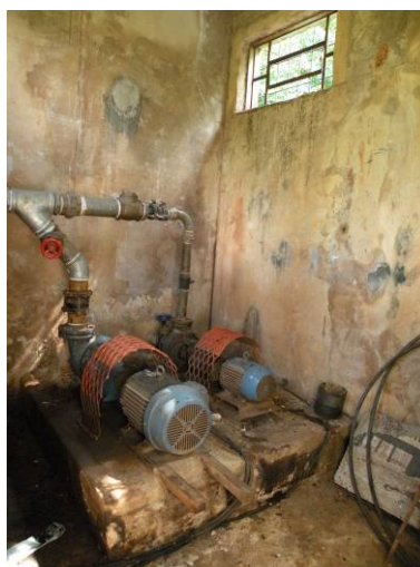
Figura 282 – Interior da elevatória.
