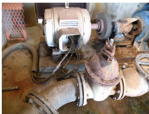
Figura 182 – Bomba da elevatória de água tratada da ETA-03.
