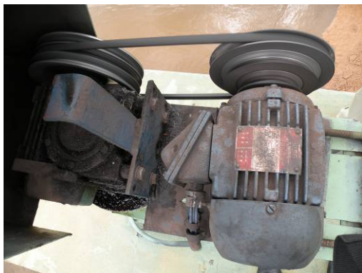
Figura 107 – Motor dos Floculadores mecanizados.
