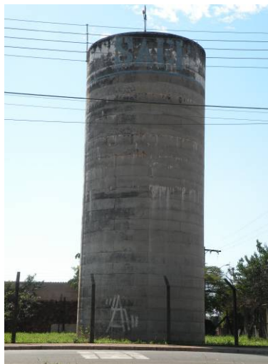
Figura 243 – Reservatório Independência (desativado).
