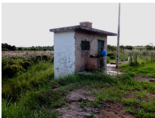
Figura 78 – Casa de bomba da elevatória de água que abastece o reservatório Cuca Fresca.
