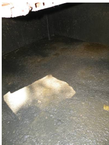
Figura 281 – Poço de chegada do esgoto bruto dos Bairros Porto Belo I e II.
