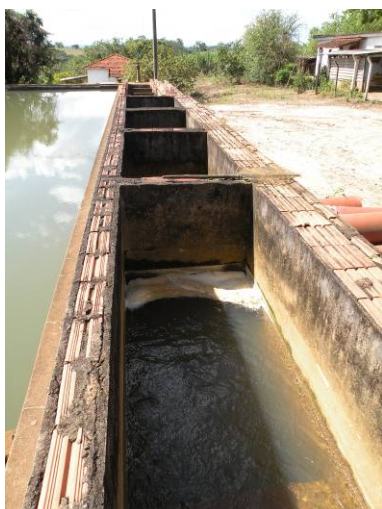
Figura 169 – Canal de floculação hidráulica (chicanas) da água coagulada.
