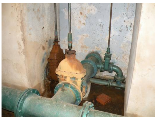
Figura 119 – Válvulas do sistema de lavagem dos filtros.
