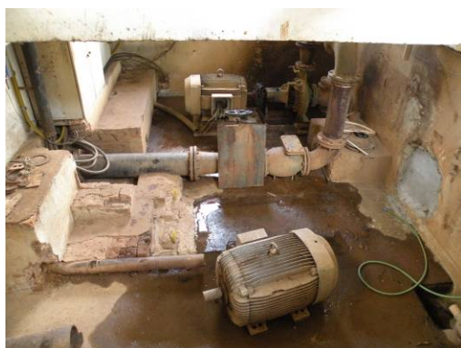
Figura 56 – Motor de uma das bombas (desativada) da casa de bombas antiga.
