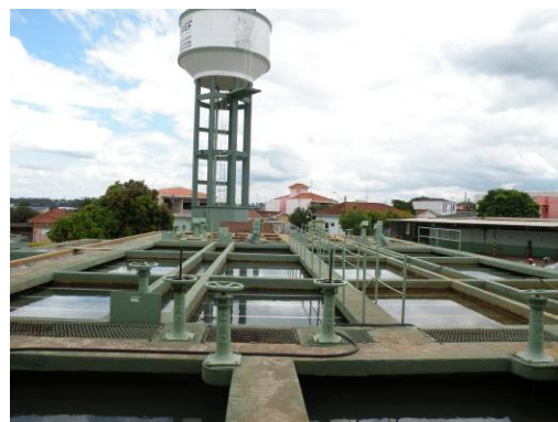
Figura 221 – Vista do reservatório ao fundo com unidades de tratamento da ET-01 à frente.
