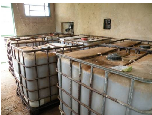
Figura 125 – Tanques de armazenamento de Cloro.
