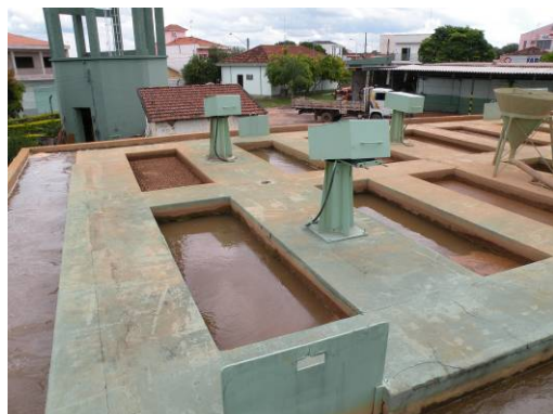
Figura 105 – Floculadores mecanizados (vista 01).
