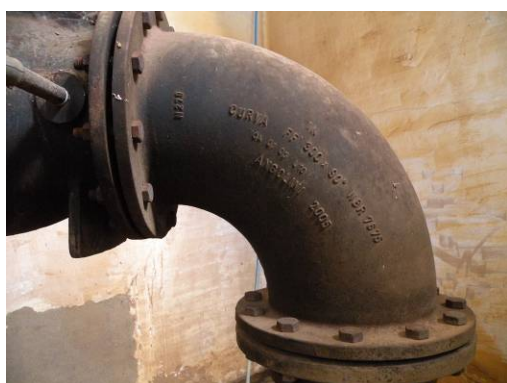
Figura 47 – Detalhe da tubulação de recalque da água bruta.
