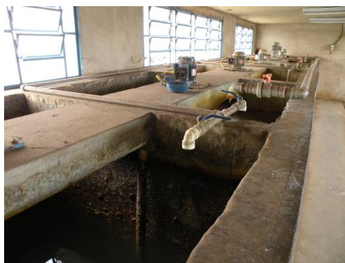
Figura 126 – Sistema de dosagem de sulfato de alumínio (não está em operação).
