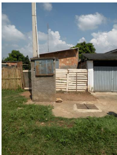
Figura 298 – Área em que está instalada a bomba submersível da elevatória (vista 01).
