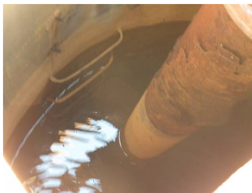
Figura 180 – Detalhe do poço de sucção da água tratada.
