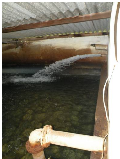
Figura 226 – Chegada de água vinda da ETA-01.
