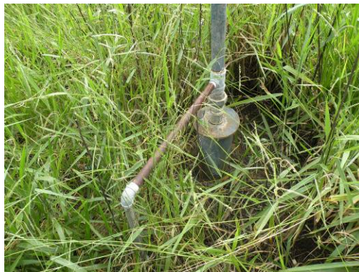
Figura 252 – Poço profundo instalado junto ao reservatório.
