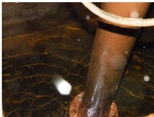
Figura 81 – Tubulação de sucção da elevatória.
