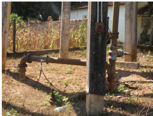
Figura 241 – Ligações clandestinas na tubulação que abastecia o reservatório.
