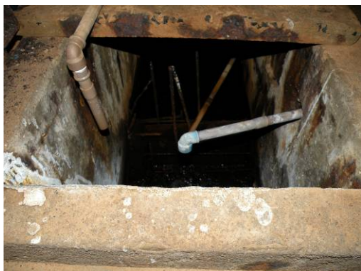
Figura 123 – Ponto de aplicação de cloro e flúor no canal de saída de água tratada para os reservatórios da ETA-01.
