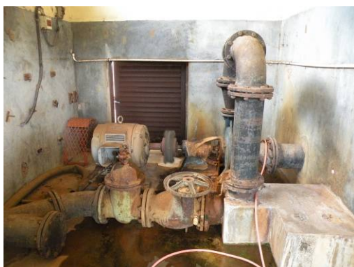
Figura 181 – Tubulações de recalque da água tratada.
