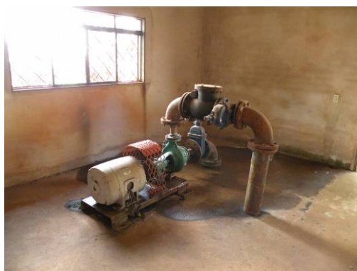
Figura 209 – Bomba e tubulação de recalque da elevatória.
