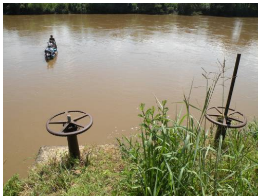
Figura 30 – Comportas das tubulações de captação de água.
