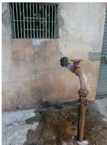
Figura 83 – Tubulação de Recalque de água bruta.
