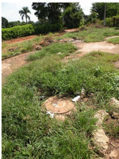
Figura 273 – Poço de visita (PV) que apresenta o vazamento.
