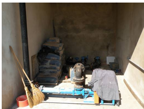
Figura 313 – Tubulação e bomba de retorno de lodo ao sistema.
