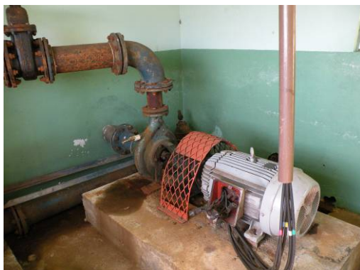
Figura 159 – Bomba 02 e tubulações.
