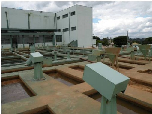
Figura 109 – Vista geral do processo de tratamento com prédio de administração ao fundo (vista 02).
