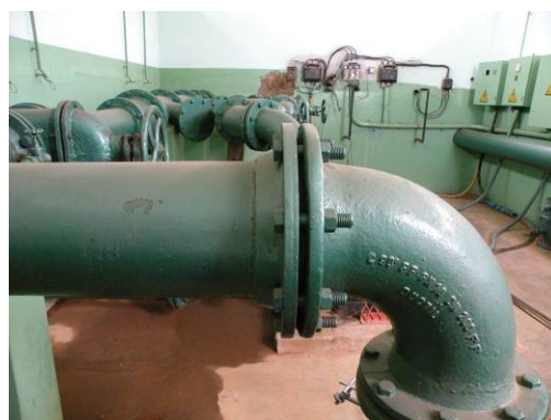
Figura 142 – Tubulações de recalque da elevatória de água tratada.
