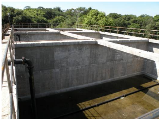
Figura 308 – Vista geral dos tanques de aeração.
