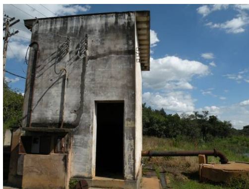
Figura 178 – Elevatória de água tratada.
