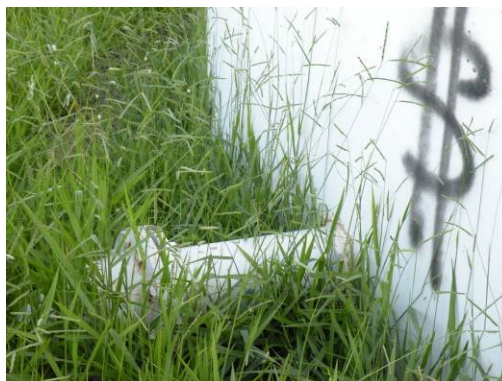
Figura 237 – Detalhe da saída de água para distribuição nos bairros.
