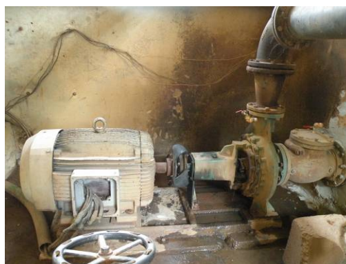
Figura 52 – Bomba da casa de bombas antiga.
