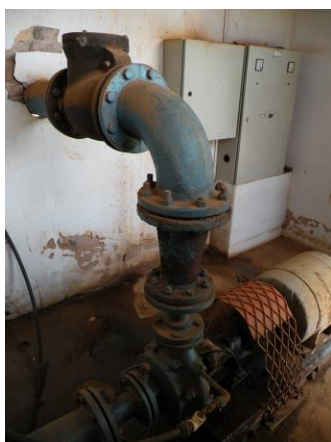
Figura 214 – Tubulação de recalque com vibração prejudicando a alvenaria de fechamento da elevatória.
