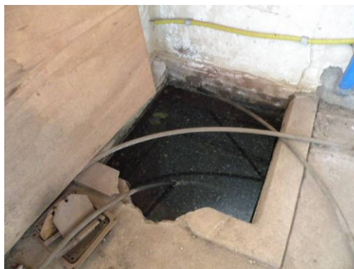
Figura 193 – Poço da elevatória totalmente preenchido de água, porém não utilizado atualmente.
