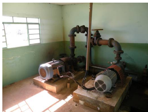
Figura 156 – Interior da elevatória.
