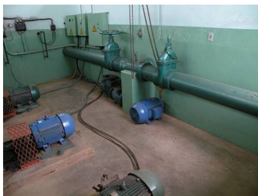
Figura 132 – Interior da elevatória (vista 02).
