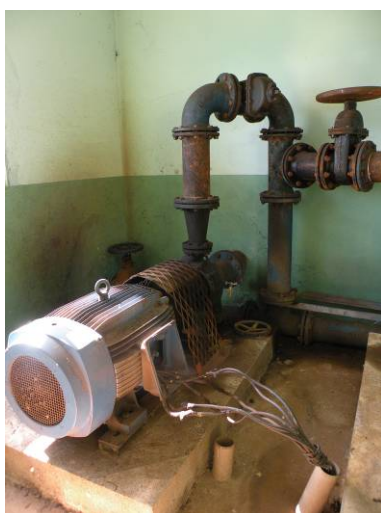
Figura 157 – Bomba 01 e tubulações de recalque da elevatória.
