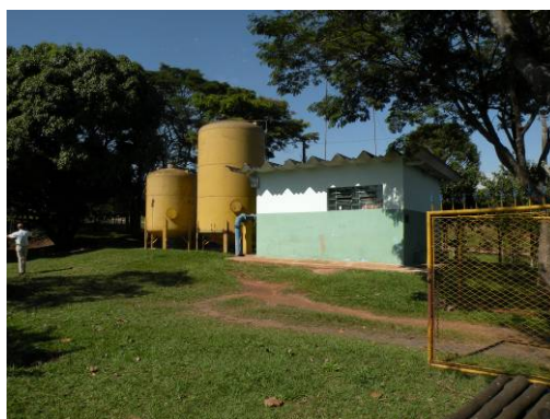
Figura 146 – Casa de química e sala do operador e tanques pressurizados de tratamento da ETA.
