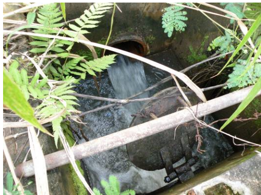
Figura 163 – Canal de chegada de água na ETA-03 (vista 01).
