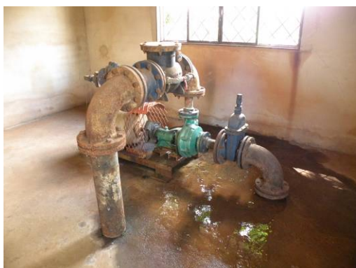
Figura 208 – Área interna da elevatória.
