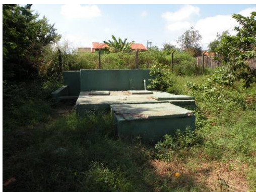
Figura 279 – Estação Elevatória de Esgoto Bruto do Jd. Residencial Porto Bello II.
