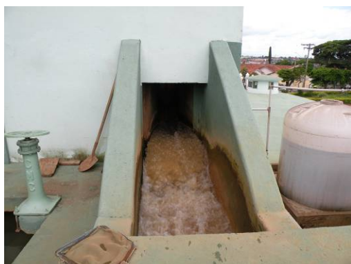
Figura 103 – Saída da Calha Parshall para o canal de distribuição de água bruta na ETA.
