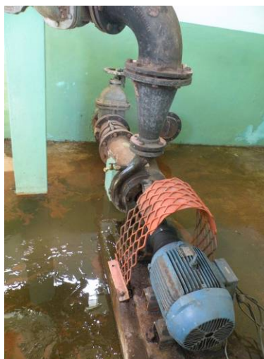
Figura 69 – Bomba de alimentação.
