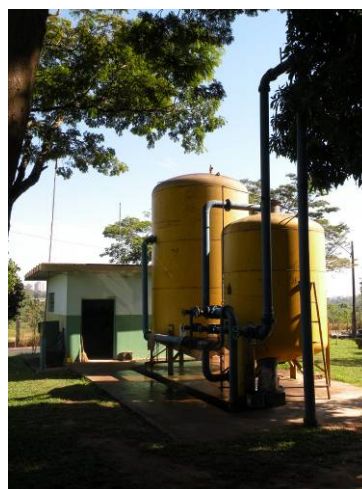
Figura 148 – Vista geral do processo da ETA-02.
