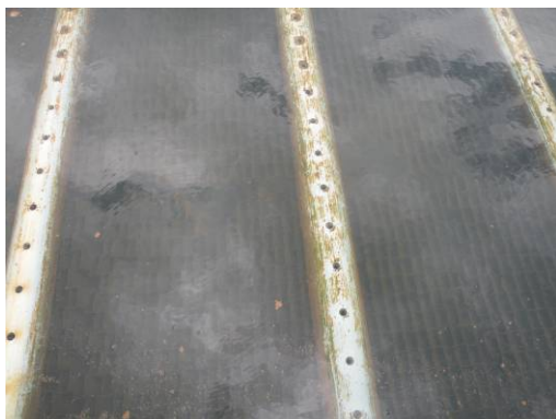
Figura 113 – Detalhe da disposição dos módulos tubulares no interior do decantador, e tubulação de coleta da água decantada.
