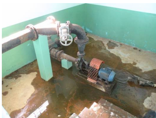
Figura 68 – Bomba e tubulações de alimentação da ETA-02.
