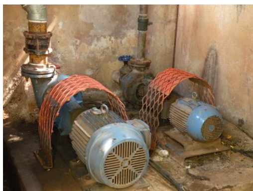
Figura 283 – Bombas de recalque do esgoto bruto.
