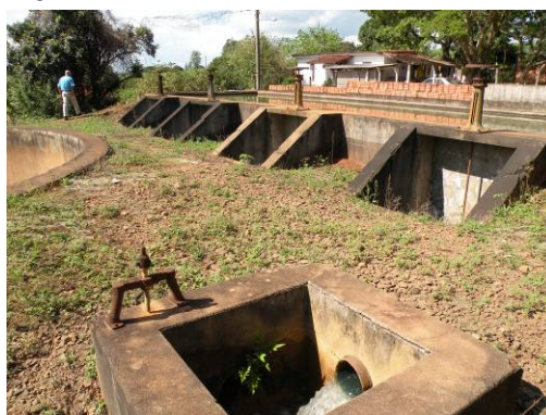
Figura 174 – vista da saída de água tratada (segue para a elevatória de água tratada).
