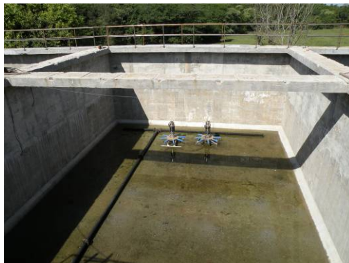
Figura 309 – Tanque de aeração central (01 de 03).
