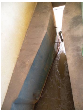
Figura 101 – Vertedor Parshall de medição de vazão na entrada da ETA-01 (vem da captação principal no Rio Mogi-Guaçu). Ponto de aplicação do sulfato de alumínio (coagulante).
