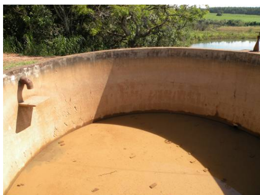
Figura 173 – Filtro Lento de areia desativado.
