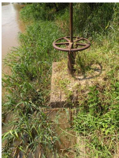
Figura 29 – Comporta da captação.
