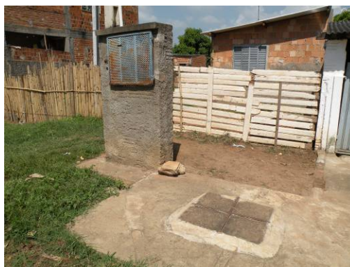
Figura 299 – Área em que está instalada a bomba submersível da elevatória (vista 02).
