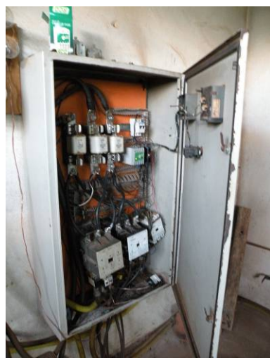
Figura 194 – Pannel da bomba da elevatória.
