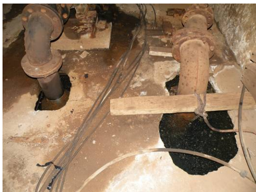
Figura 192 – Detalhe das tubulações de recalque da elevatória (ambas inativas).
