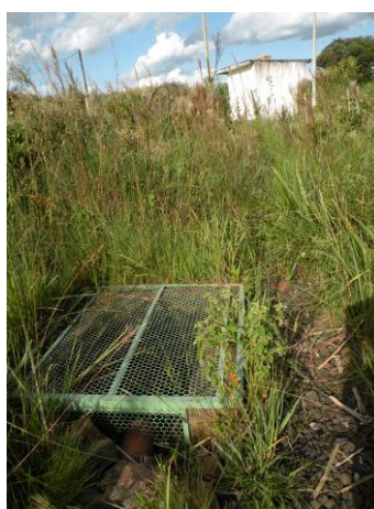
Figura 87 – Chegada da tubulação de captação na tubulação de encaminhamento à elevatória (vista 02 – Elevatória ao fundo)
