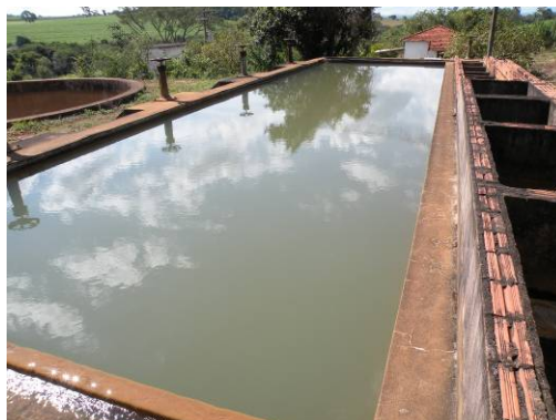
Figura 170 – Decantador retangular da ETA.
