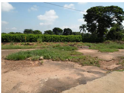
Figura 271 – Ponto de vazamento de esgoto no PV quando chove devido a interligações clandestinas de tubulações de esgotamento sanitário.
