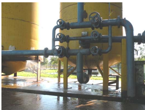
Figura 149 – Detalhe das tubulações da ETA. Nota-se grande vazamento de água no primeiro tanque do processo.
