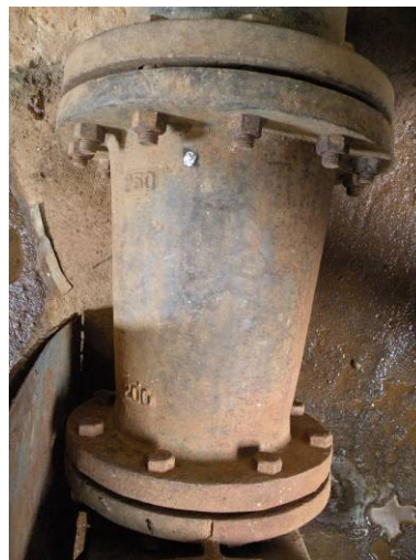
Figura 55 – Detalhe da redução 250x200 para a tubulação de recalque antiga da captação (ainda em funcionamento).
