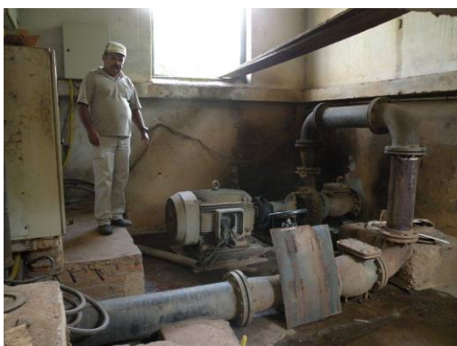
Figura 51 – Interior da casa de bombas antiga.
