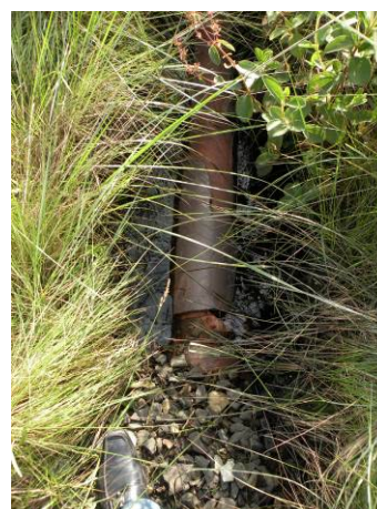
Figura 89 – Detalhe da água escorrendo para o interior da tubulação da captação (vista 02).
