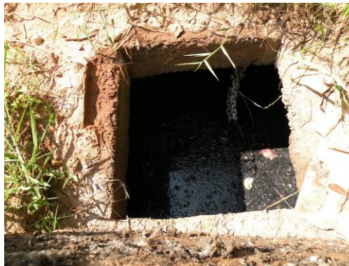
Figura 293 – Poço em que está submersa a bomba.
