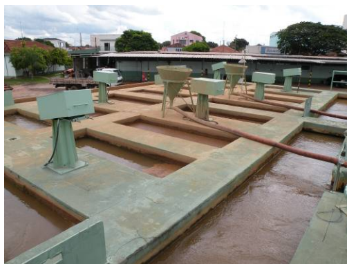
Figura 106 – Floculadores mecanizados (vista 02).
