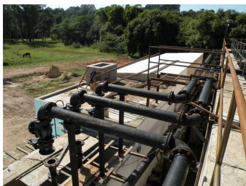
Figura 307 – Tubulação de distribuição do efluente para os tanques de aeração.
