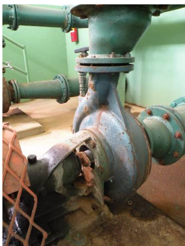
Figura 137 – Detalhe da Bomba 02.
