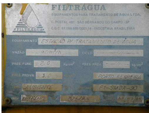
Figura 151 – Placa de identificação do fabricante e especificações dos equipamentos da ETA-02.
