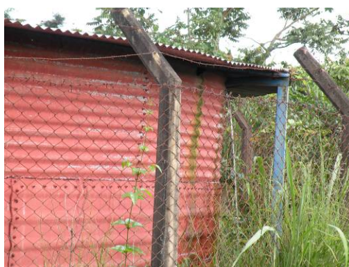
Figura 254 – “Ladrão” do reservatório transbordando (possível problema ou ausência no comando liga/desliga da elevatória do Cuca Fresca, ou do poço).
