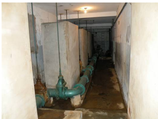
Figura 117 – Saída dos filtros.
