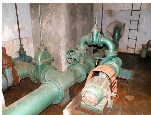
Figura 120 – Tubulações, válvulas e bomba de pressurização de água do sistema de lavagem dos filtros.
