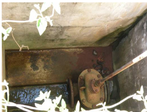
Figura 176 – Válvula de manobra da saída de água tratada.
