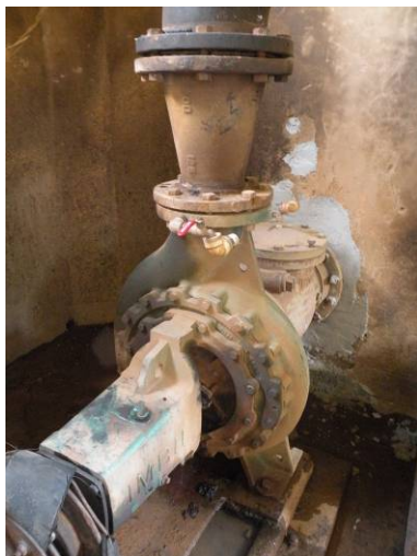
Figura 54 – Tubulação de recalque.
