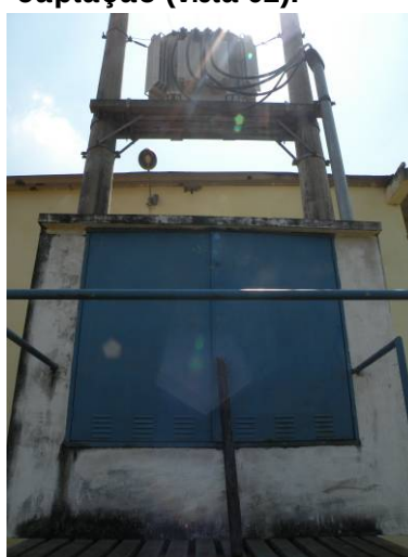
Figura 63 – Transformador da Subestação.
