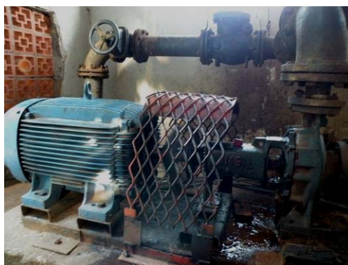
Figura 187 – Detalhes da bomba e tubulação de recalque.
