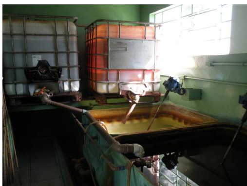
Figura 153 – Sala de produtos químicos (sulfato de alumínio e hipoclorito de sódio).
