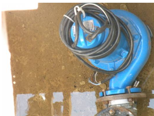
Figura 306 – Bomba de alimentação de um dos tanques de aeração (três no total).
