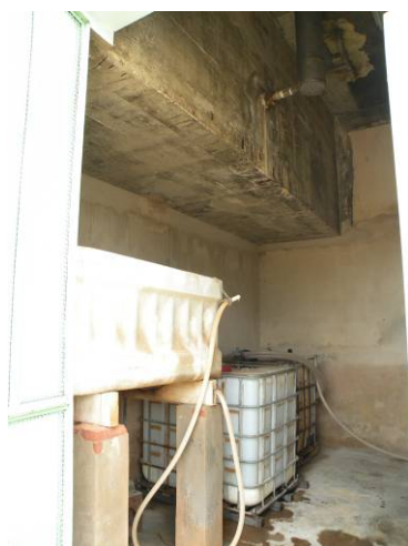
Figura 121 – Tanques de estocagem de cloro.
