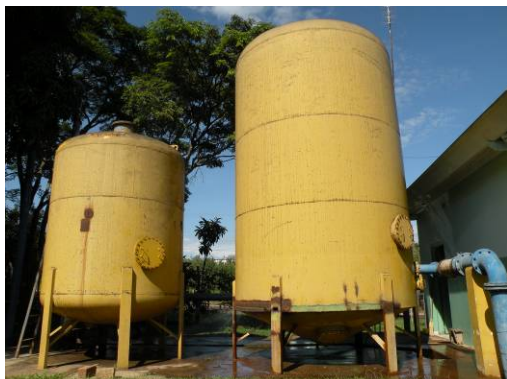
Figura 147 – Tanque de floculação/decantação à direita e filtro à esquerda.
