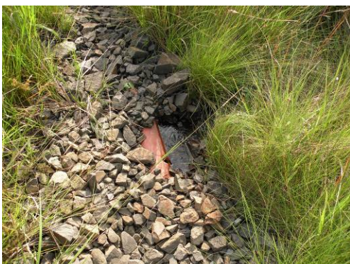
Figura 88 – Detalhe da água escorrendo para o interior da tubulação da captação (vista 01).
