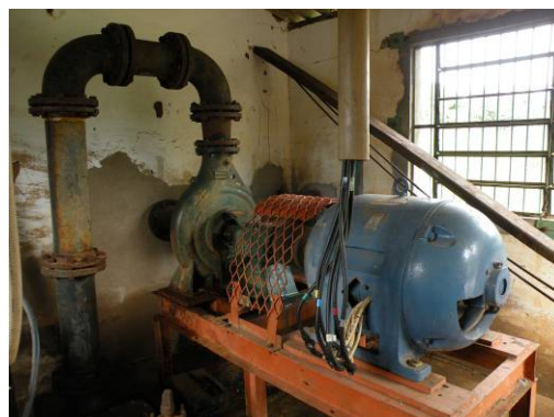
Figura 203 – Bomba de pressurização da água tratada e tubulação de recalque.
