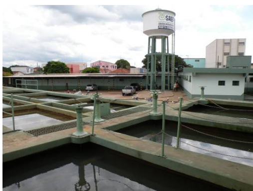
Figura 222 – Vista do Reservatório que é utilizado para lavagem dos filtros (ao fundo) e filtros da ETA-01 (à frente).
