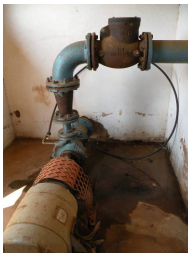
Figura 213 – Bomba e tubulação de recalque.
