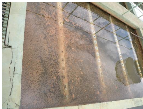
Figura 114 – Decantador que está com problemas em seu funcionamento por defeitos nos módulos tubulares.
