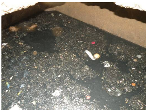
Figura 294 – Esgoto bruto no interior do poço de sucção da bomba.
