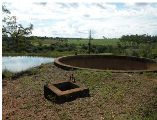
Figura 172 – Vista do Filtro Lento desativado que é usado como decantador adicional quando a água apresenta valores elevados de turbidez.
