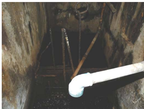
Figura 124 – Detalhe do ponto de aplicação de cloro e flúor no canal de saída de água tratada para os reservatórios da ETA-01.
