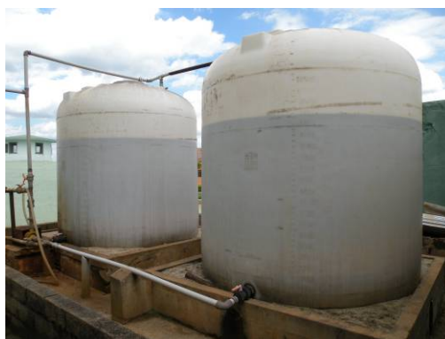
Figura 128 – Tanques de armazenamento de sulfato de alumínio.
