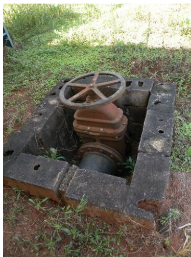
Figura 48 – Válvula de manobra no início da linha de recalque que leva a água bruta à ETA-01.
