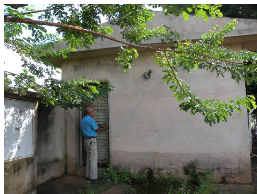
Figura 207 – Casa de bomba da elevatória.
