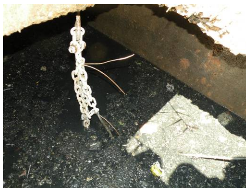
Figura 295 – Poço com corrente de içamento da bomba submersível.
