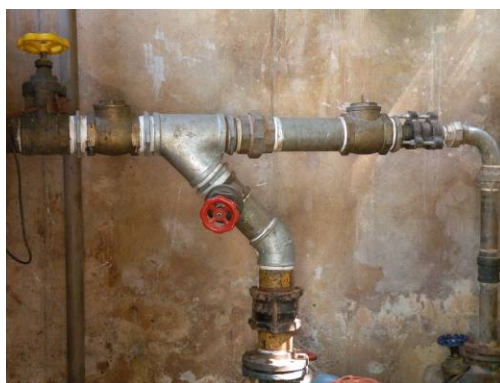
Figura 284 – Tubulação de recalque da elevatória.
