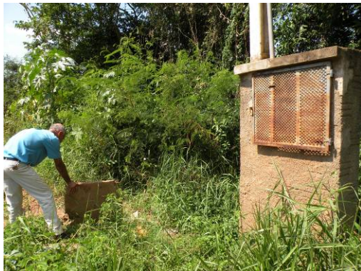
Figura 292 – Área em que está instalada a bomba submersível da elevatória (vista 01).
