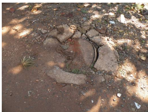
Figura 276 – Detalhe do PV destruído que apresenta os vazamentos quando são observadas chuvas de média e grande intensidades.
