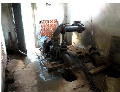
Figura 185 – Interior da Elevatória do Cristo.
