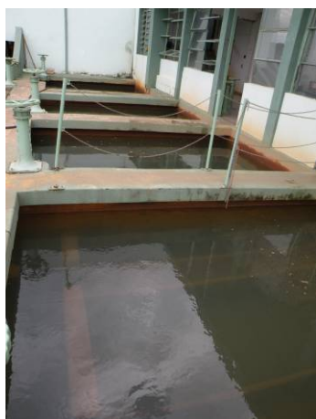
Figura 115 – Filtros de areia da ETA.
