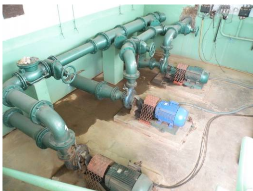
Figura 131 – Interior da elevatória.
