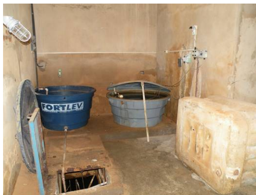
Figura 122 – Ponto de aplicação dos produtos químicos (cloro e flúor), tanques de solução dos produtos e bombas dosadoras de cloro e flúor na água tratada.
