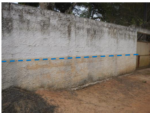
Figura 25. Marca d'água em muro com aproximadamente 1,0 metro.
