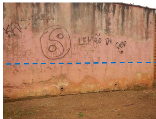
Figura 22. Marca d água de aproximadamente um metro de altura causada pela inundação de 2016.
