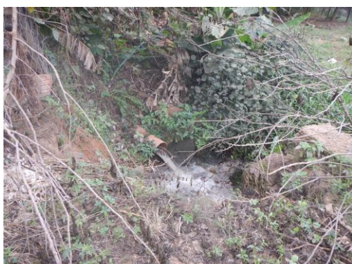
Figura 11. Ponto de Lançamento de esgoto in natura no Rio Mogi Guaçu.
