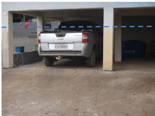
Figura 23. Marca d'água de aproximadamente 1,5 ocasionada pela inundação de 2016 na área do Boa Vista 01, notar o método construtivo das moradias, construídas muito altas em relação ao nível da rua
