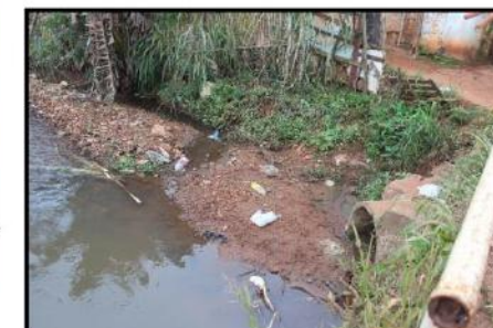
Assoreamento do sistema de drenagem que deságua no trecho a jusante da travessia.
