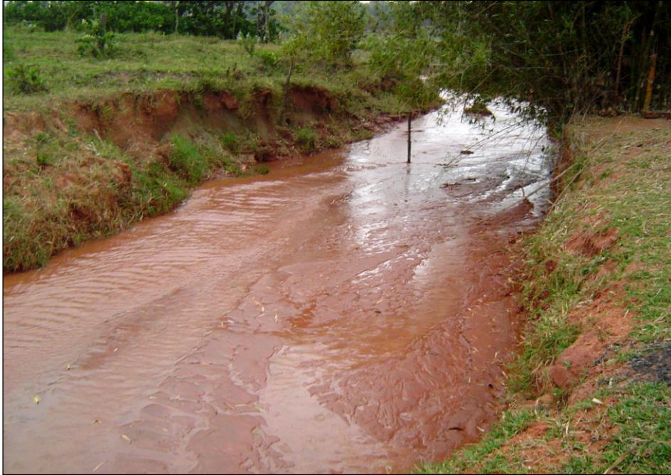
Figura 22 – Taludes marginais sujeitos a erosão (Ministério das Cidades, Instituto de Pesquisas Tecnológicas do Estado de São Paulo – IPT, 2007).
