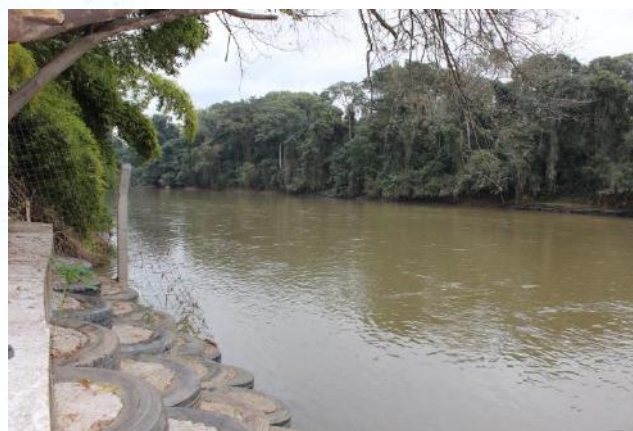
FOTO 22 - Rio Mogi Guaçu. Destaque para a contenção de pneus para evitar o solapamento do talude marginal.
