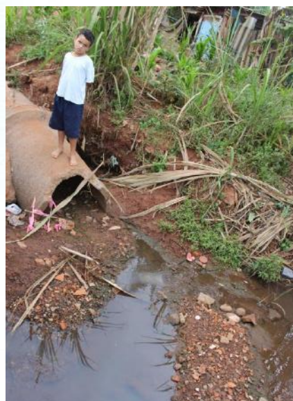
FOTO 8 - Assoreamento do sistema de drenagem, trecho a montante da travessia.
