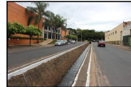
Detalhe do córrego de pequeno porte, o qual causa a inundação na área.
