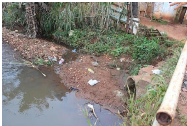
FOTO 7 - Assoreamento do sistema de drenagem que deságua no trecho a jusante da travessia.
