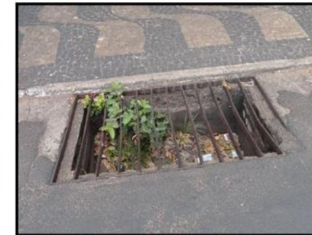
Detalhe do assoreamento do bueiro no local. O assoreamento do sistema de drenagem pode intensificar a inundação na área.
