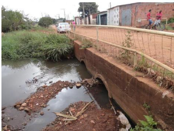
FOTO 3 - Vista a montante das galerias meia lua. Destaque para o assoreamento por solo e entulho.
