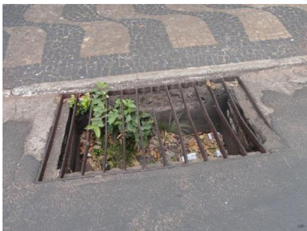
FOTO 25 - Detalhe do assoreamento do bueiro no local. O assoreamento do sistema de drenagem pode intensificar a inundação na área.
