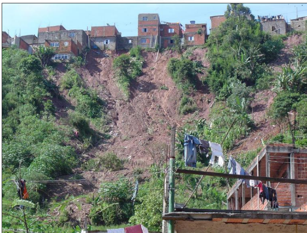
Figura 4 – Deslizamentos planares induzidos pela ocupação (Ministério das Cidades, Instituto de Pesquisas Tecnológicas do Estado de São Paulo – IPT, 2007).
