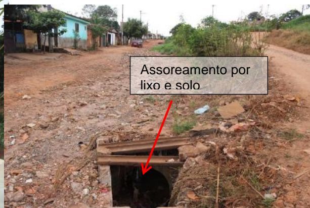
FOTO 6 - Boca de lobo aberta no local. Destaque para a grande quantidade de lixo e solo.
