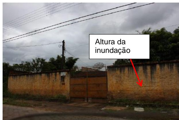
FOTO 20 - Detalhe da altura atingida pelo último evento de inundação na área.
