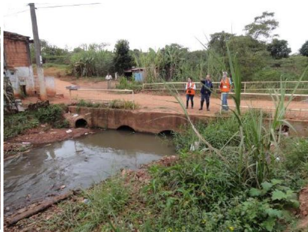
FOTO 2 - Vista a jusante da área. A travessia é composta por duas galerias meia lua, totalmente assoreadas.
