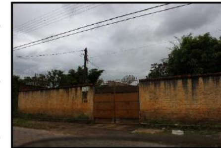
Detalhe da altura atingida pelo último evento de inundação na área.
